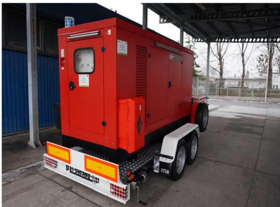
Fot. 10 Przykład agregatu prądotwórczego
